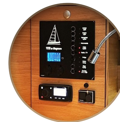
Tablica Ampreflex z ryciną łódki, mini monitorem pokazującym stan naładowania akumulatorów oraz zapewnienia ziorników, posiada porty ładowania USB i 12V.
